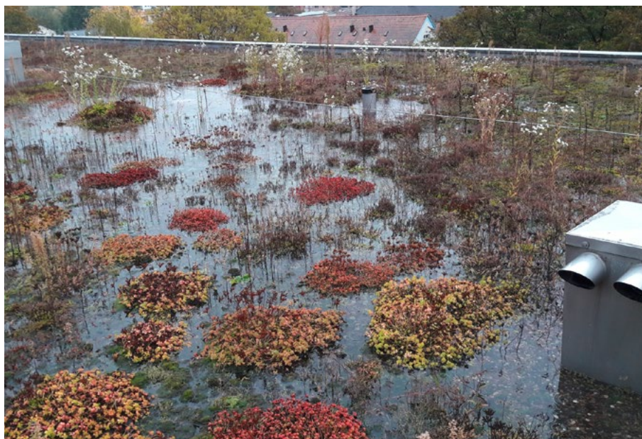
Kein Naturpool, sondern das unter Wasser stehende Dach der Brunnenhofstrasse 10.
